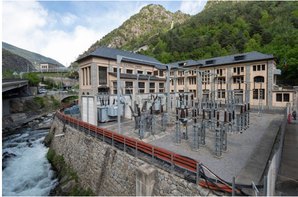
Central hidroelèctrica de FEDA al sud de la parròquia d'Encamp. (imatge: FEDA - Forces Elèctriques d'Andorra)
